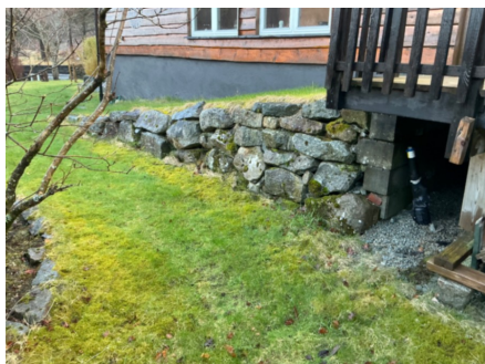
Rekkverk på gangvei er ikke etablert.
