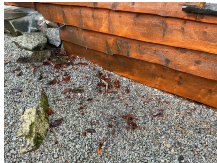
Liten/ingen avstand mellom kledning og bakke.
