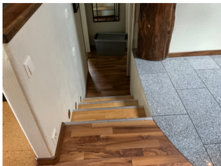
Rekkverk på innvendig trapp er ikke etablert.
