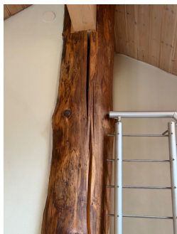
Synlige sprekker på innvendig søyle.
