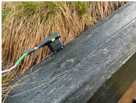
Fukt/råte på vindski.
