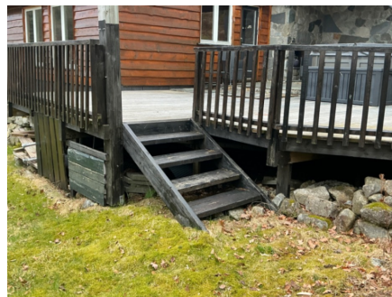
Rekkverk på utvendig trapp er ikke etablert.
