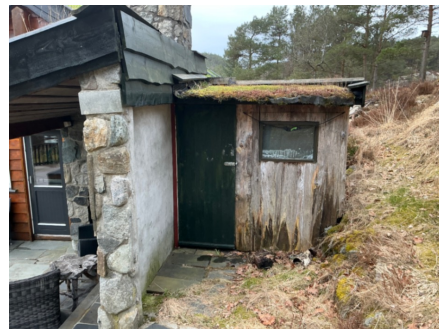
Utvendig bod bygget inntil bolig. Anbefales fjernet.
