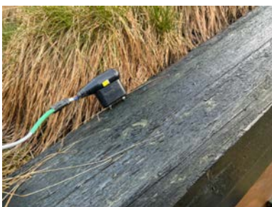
Fukt/råte på vindski.
