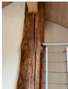
Synlige sprekker på innvendig søyle.
