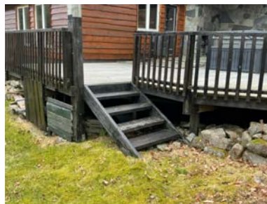
Rekkverk på utvendig trapp er ikke etablert.
