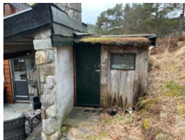
Utvendig bod bygget inntil bolig. Anbefales fjernet.
