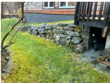
Rekkverk på gangvei er ikke etablert.
