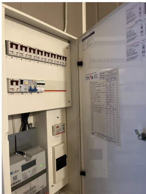
EL-skap med automatsikringer
