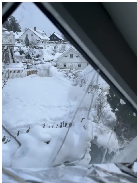
Sprekt glass i 2.etasje
