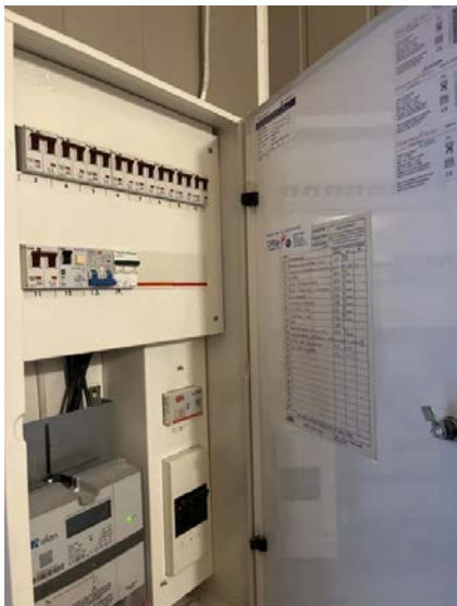
EL-skap med automatsikringer
