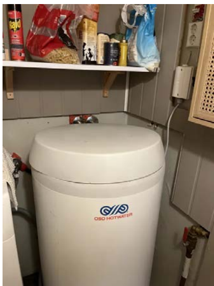
Overflater er ikke helt ferdigstilt på vaskerom omkring varmtvannsbereder.
