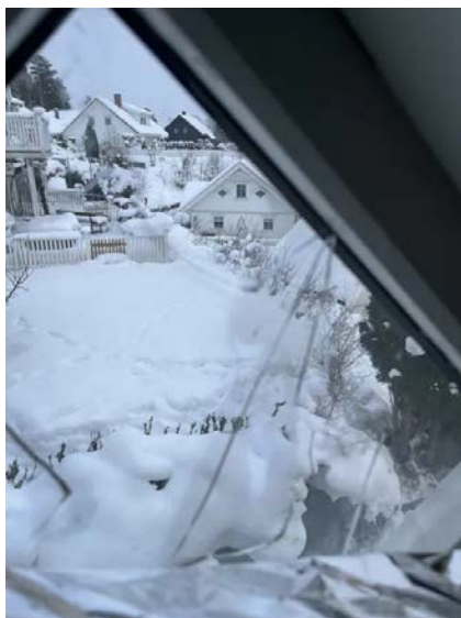
Sprekt glass i 2.etasje
