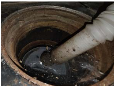
Sluk under dusjkabinett
