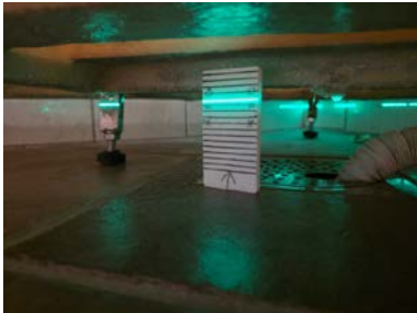
Laser plassert ved døren, ca. 20mm høydeforskjell
