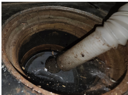
Sluk under dusjkabinett
