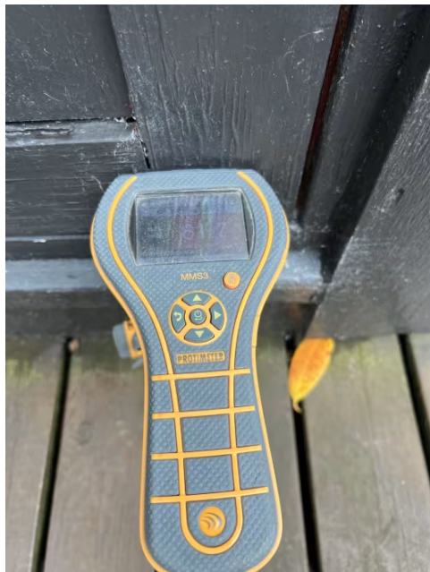
Fukt i terrassedør underetasje.
