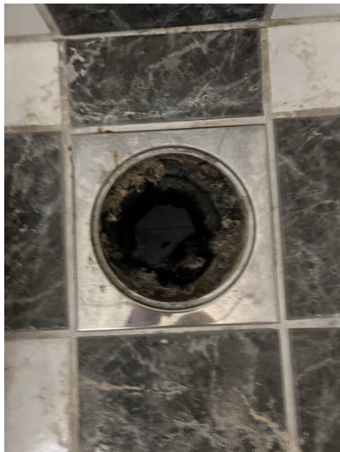
Sluk under dusjkabinett.
