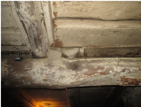
Har tidlige blitt smurt inn i mot borebiller
