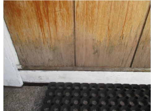
Trenger noe utvendig overflatebehandling.
