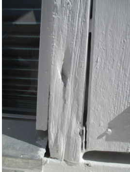
Råteskade på vindu i stue første etasje.
