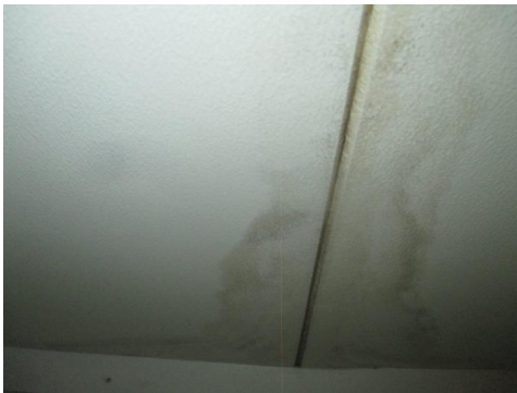
Eldre fuktmerker på vaskerommet.
