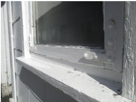
Eldre slitt vindu i første etasje.
