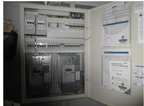
Sikringsskap for begge etasjer i trappegang til andre etasje.
