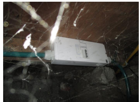
Hovedinntaket i grovkjeller.
