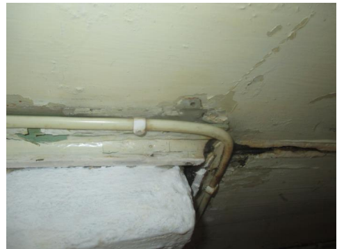
Eldre lekkasje ved pipe.
