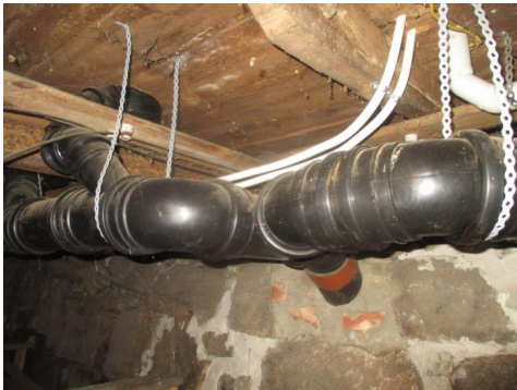
Avløpsrør av plast.
