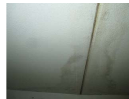
Eldre fuktmerker på vaskerommet.
