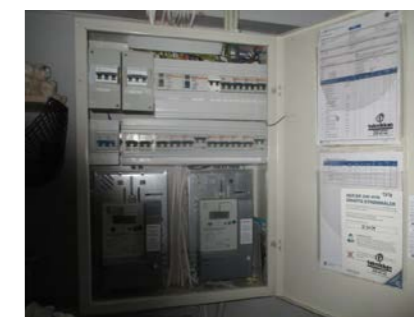
Sikringsskap for begge etasjer i trappegang til andre etasje.
