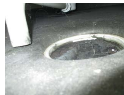
Sluk under dusjkabinett.
