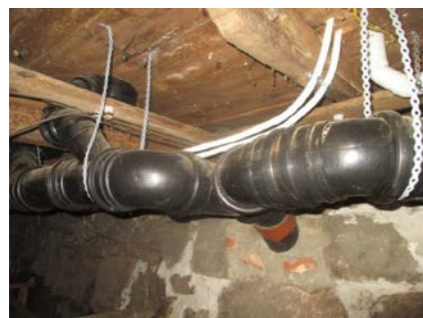
Avløpsrør av plast.
