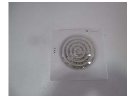
Vifte i ytterveggen.
