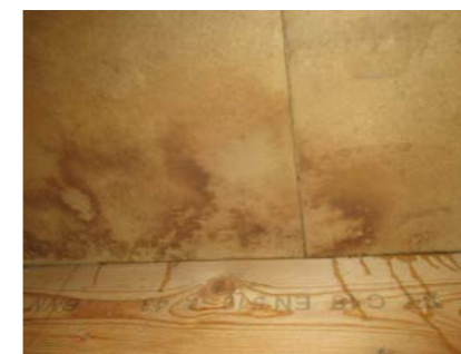
Eldre fuktmerker på undersiden av terrasse i bakgården.
