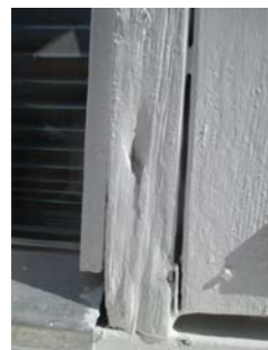
Råteskade på vindu i stue første etasje.
