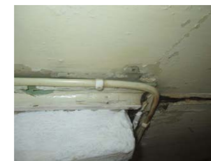
Eldre lekkasje ved pipe.
