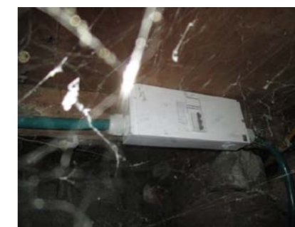
Hovedinntaket i grovkjeller.
