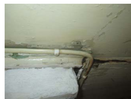
Eldre lekkasje ved pipe.
