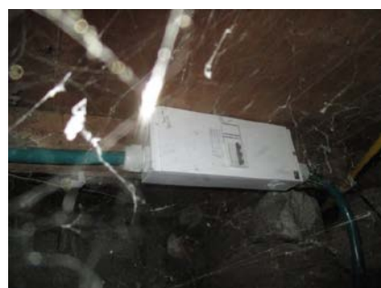
Hovedinntaket i grovkjeller.
