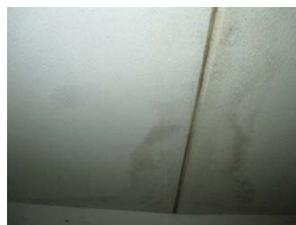
Eldre fuktmerker på vaskerommet.
