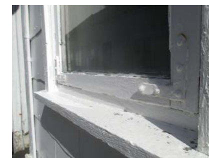
Eldre slitt vindu i første etasje.
