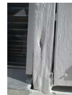
Råteskade på vindu i stue første etasje.
