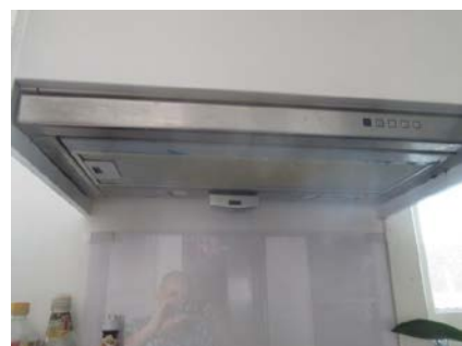
Ventilator. FØRSTE > KJØKKEN
