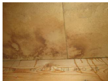
Eldre fuktmerker på undersiden av terrasse i bakgården.
