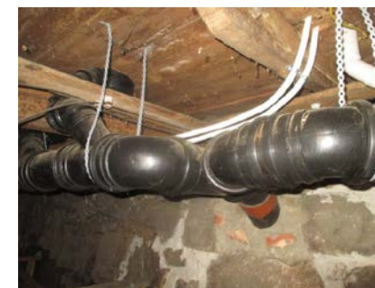
Avløpsrør av plast.
