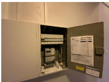
EI-skap med automatsikringer.
