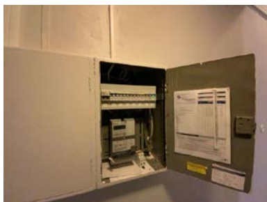
El-skap med automatsikringer.
