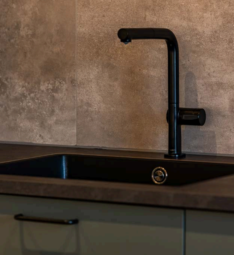
Det er også montert lekkasjestopper i benkeskap.
