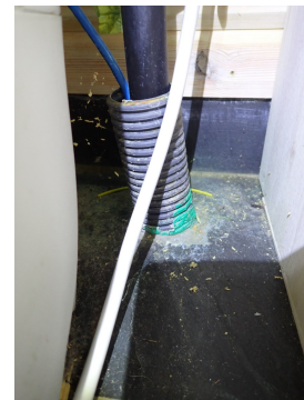
Viser røroppstikk vannledning uten mansjett
