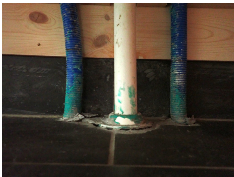
Viser røroppstikk under mansjetter under servantskap.
