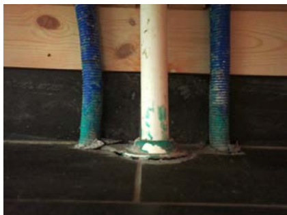
Viser røroppstikk under mansjetter under servantskap.
