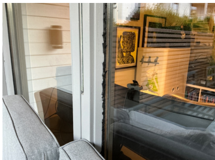
Skader på utvendig gummi tetting.
