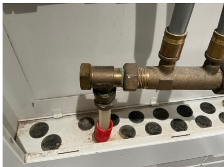
Korrosjon på fordelerstokken.
