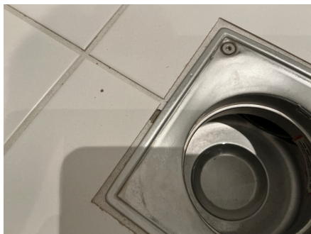
Avskalling i fug rundt sluk.
