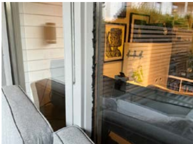
Skader på utvendig gummi tetting.
