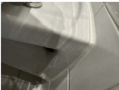
Sprekker i toalettet.
