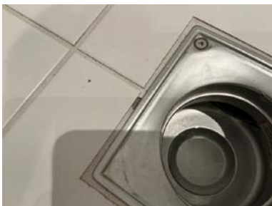
Avskalling i fug rundt sluk.
