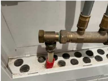
Korrosjon på fordelerstokken.
