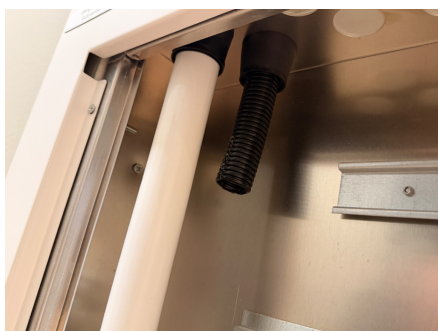
Avløp fra fordelerskap for vannledninger
