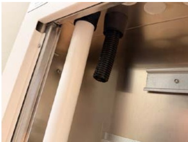
Avløp fra fordelerskap for vannledninger
