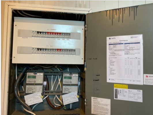
Sikringskap i felles trappegang,
