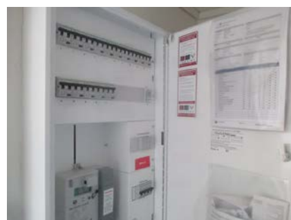
Sikringsskapet er plassert på teknisk rom.
