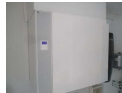
Selve enheten for balansert ventilasjon.
