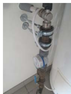
Innvendig stoppekran med vannmåler ved siden av bereder.
