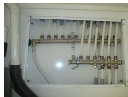
Fordelerskapet på teknisk rom.
