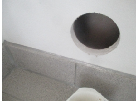
Hulltaking fra teknisk rom
