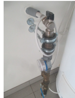
Innvendig stoppekrane med vannmåler
