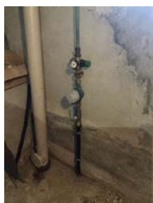
Vannmåler og stoppekran i kjeller.
