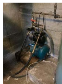
Vannpumpe er ikke i bruk, men er tilsynelatende fortsatt tilkoblet til anlegget.
