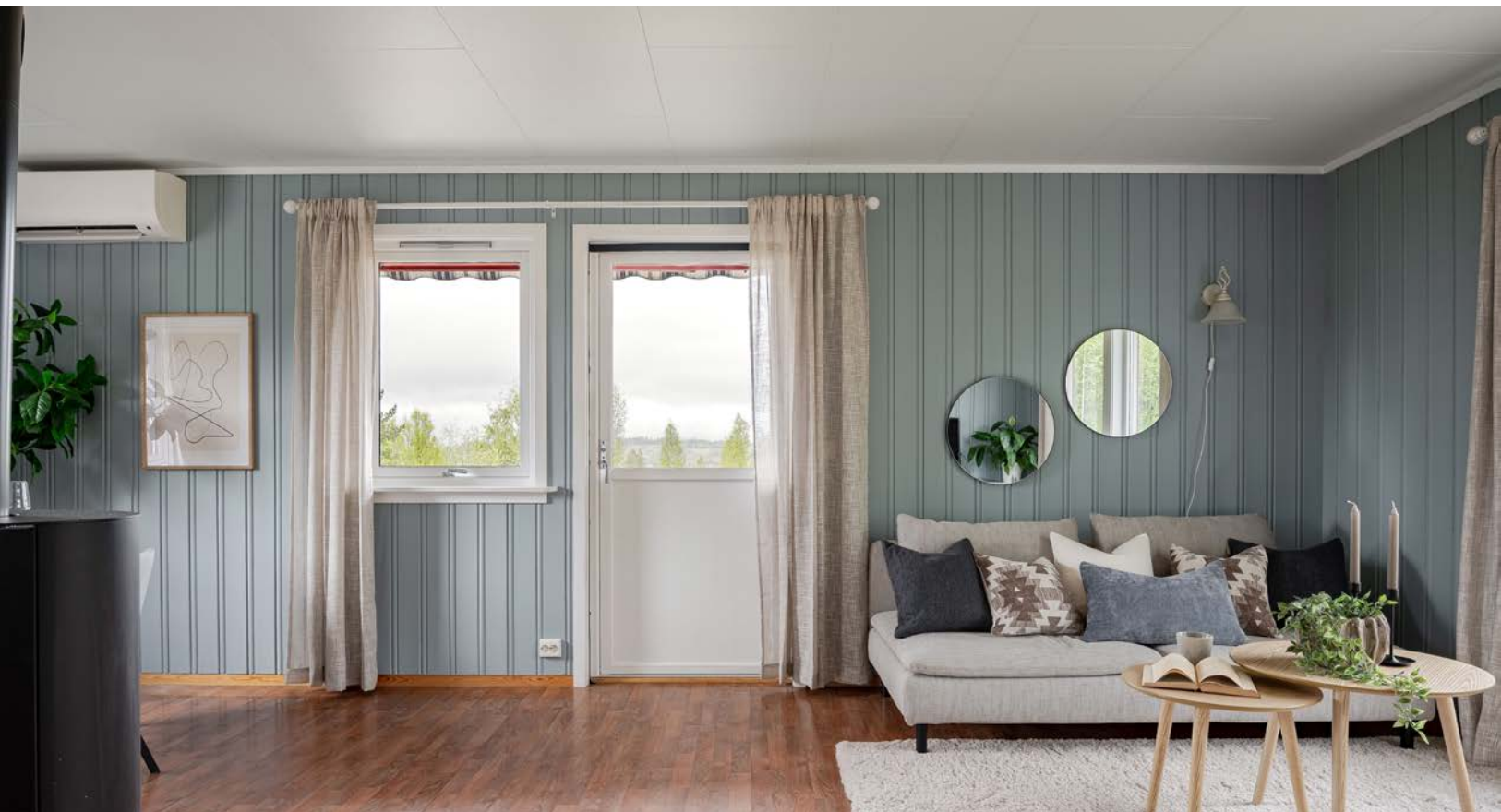
Det ble montert luft-til-luft varmepumpe i 2025 som sørger for en god og jevn varme på vinterstid.
