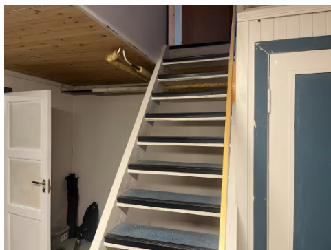
Mangler rekkverk på en side.
