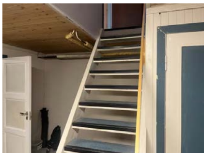
Mangler rekkverk på en side.
