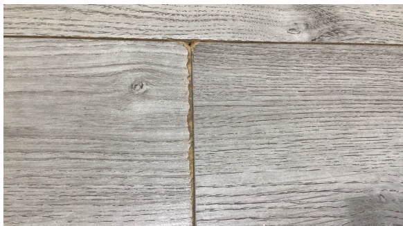
Eksempel på skadet gulv.
