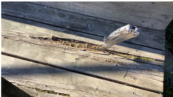
Råteskadet terrassebord i trapp.
