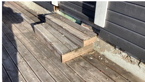
Trapp til balkongdør har enkel utførelse.
