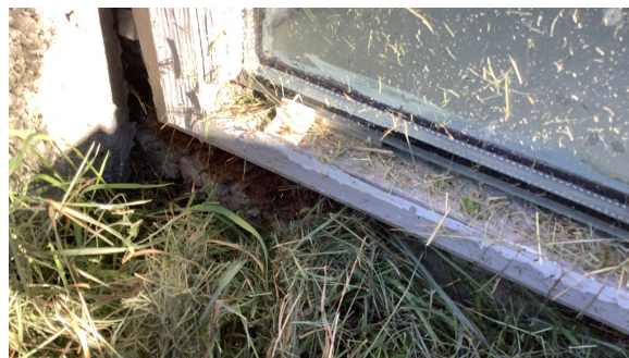
Manglende glasslist i bunnen av vindu.
