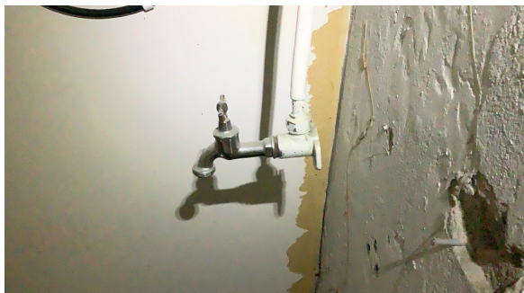
Vannkran er løs.
