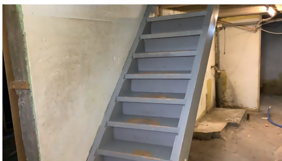
Kjellertrapp mangler rekkverk.
