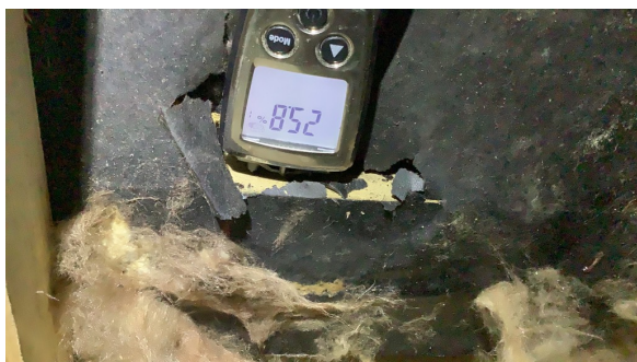
Det måles skadelig fuktinnhold i påforing på grunnmur.
