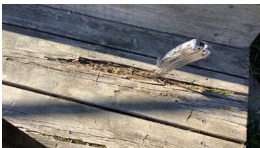
Råteskadet terrassebord i trapp.
