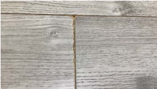
Eksempel på skadet gulv.
