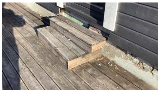
Trapp til balkongdør har enkel utførelse.
