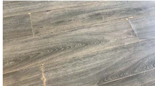
Eksempel på skadet gulv.
