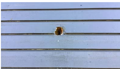
Hull inn i veggkonstruksjonen.
