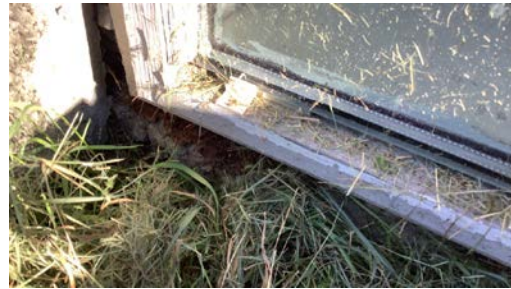
Manglende glasslist i bunnen av vindu.
