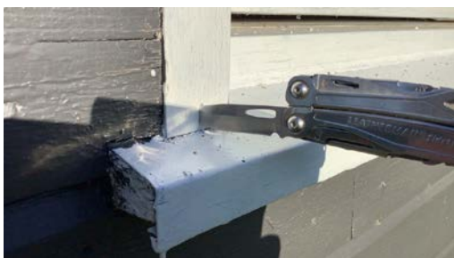
Omramming er ført helt ned til vindu, og dette har stedvis ført til råteskader.
