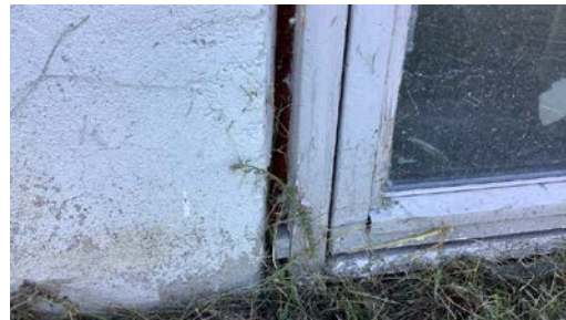
Puss er ikke påført mellom grunnmur og vindu.
