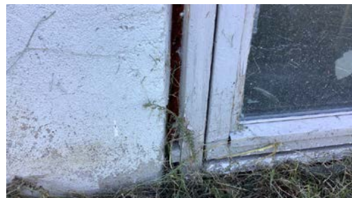
Puss er ikke påført mellom grunnmur og vindu.
