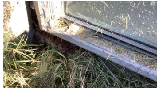
Manglende glasslist i bunnen av vindu.
