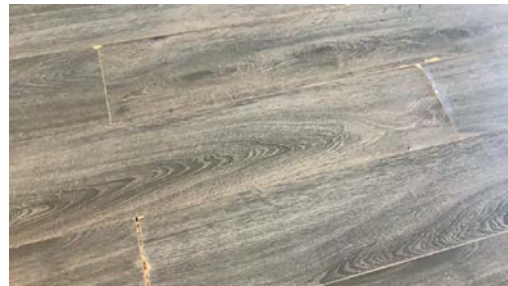
Eksempel på skadet gulv.
