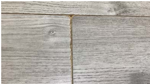
Eksempel på skadet gulv.
