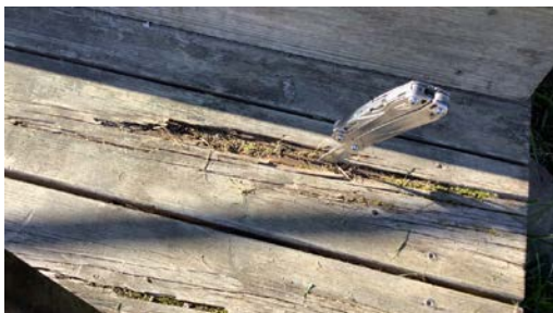
Råteskadet terrassebord i trapp.
