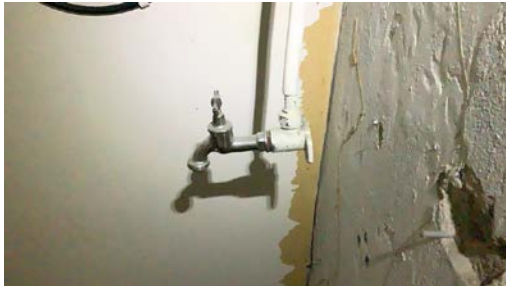
Vannkran er løs.
