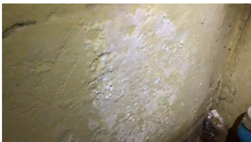
Eksempel på saltutslag på grunnmur.
