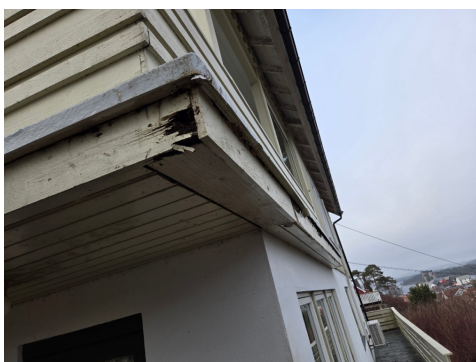
Synlig råteskade i trevirke.
