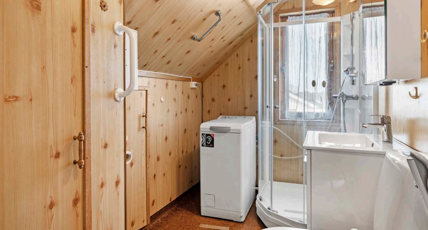
Bad i 2. etg. - Badet er av eldre dato med behov for modernisering
