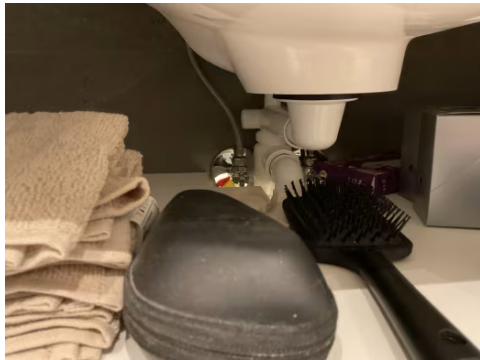
Avløp i plast med to stk ballofix stoppekraner
