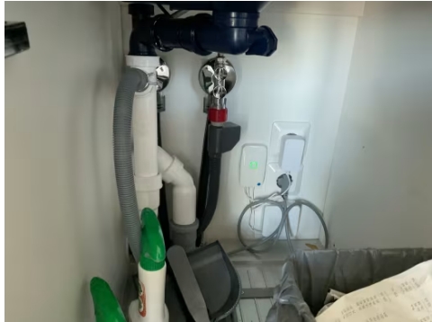
Rørøpplagg i plast med aquasafe (automatisk vannstengeventil)
