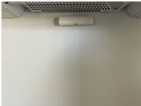
Komfyrvakt på kjøkken over induksjostopp
