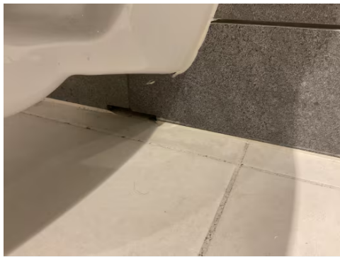
Drenering fra innebygget sisterner
