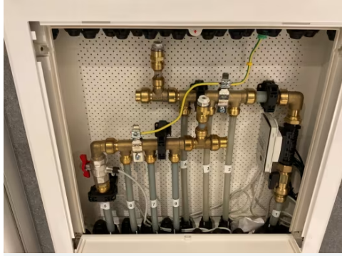
Vannfordelingskap for vannbåren varme
