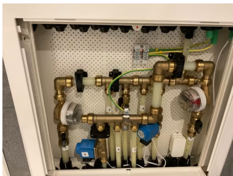
Vannfordelingskap til leiligheten
