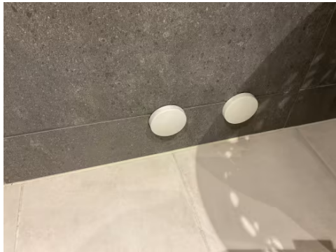
Drenering fra fordelingskap
