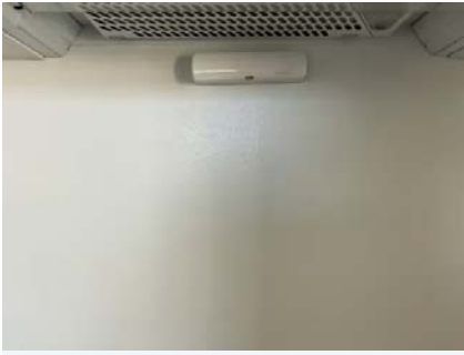
Komfyrvakt på kjøkken over induksjostopp
