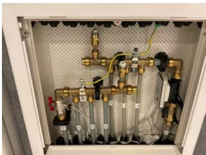
Vannfordelingskap for vannbåren varme
