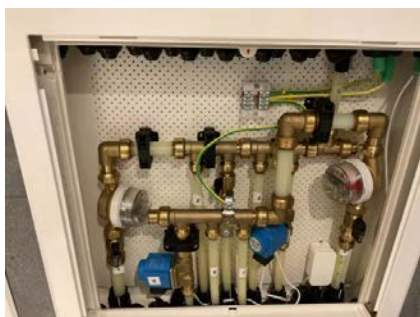
Vannfordelingskap til leiligheten
