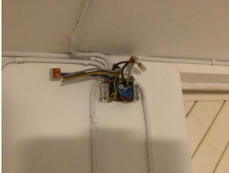
Bildet viser manglende deksel.
