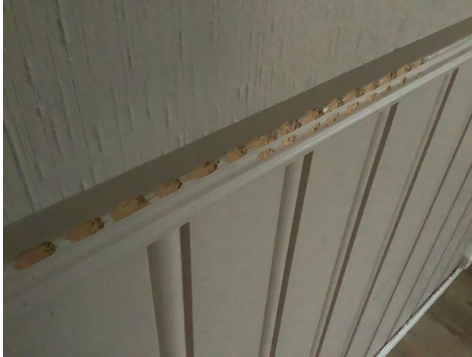
Bildet viser eksempel på bruksslitasje.
