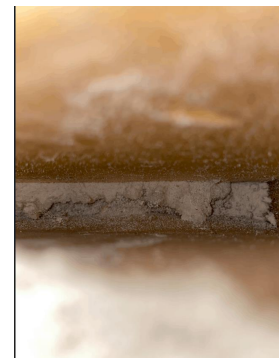
Bildet viser hulltaking og at det ikke er treverk å måle fuktinnhold i.
