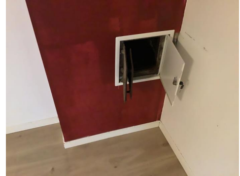
Bildet viser at pipevanger ikke er synlige og det mangler ildfast plate på gulv under sotluke.
