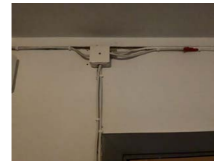
Bildet viser ufagmessig montering.
