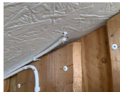
Bildet viser klypte kabler, og disse går til koblingsboks.
