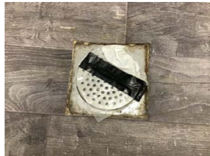
Bildet viser at vinylbelegg er grovt avsluttet mot slukrist.
