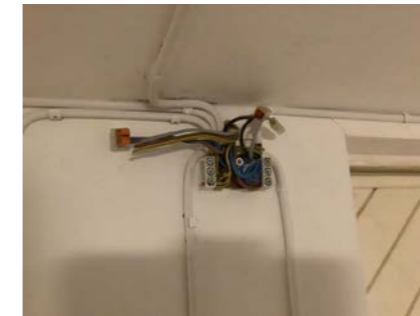
Bildet viser manglende deksel.
