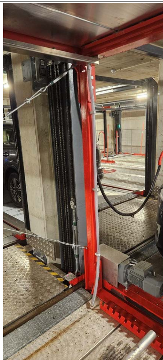
Foto 64: Avløp fra plattform over
