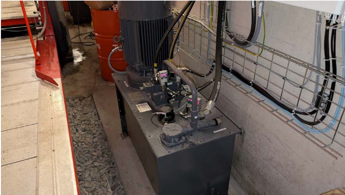
Foto 31: Hydraulikk-aggregatet, ingen dryppekar
