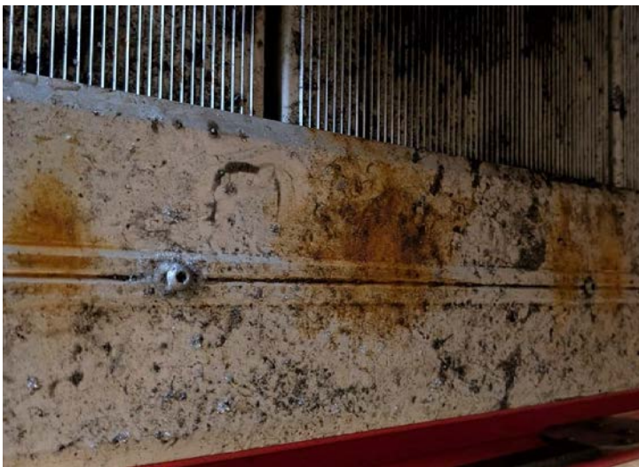
Foto: 36 Merker fra jernoksid og vann fra drenering på plattform
