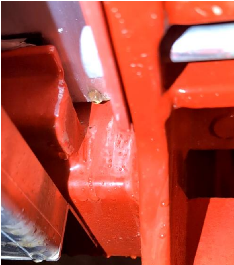
Foto 35: Tett drenering: vann drypper forbi renne og ned på plattform (utklipp fra videoklipp), BK2
