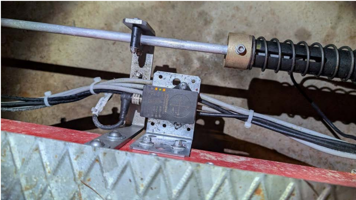
Foto 41: Vibrasjons-/temperaturmåler på plattform lokalisert ved aktuator for låsebolter
