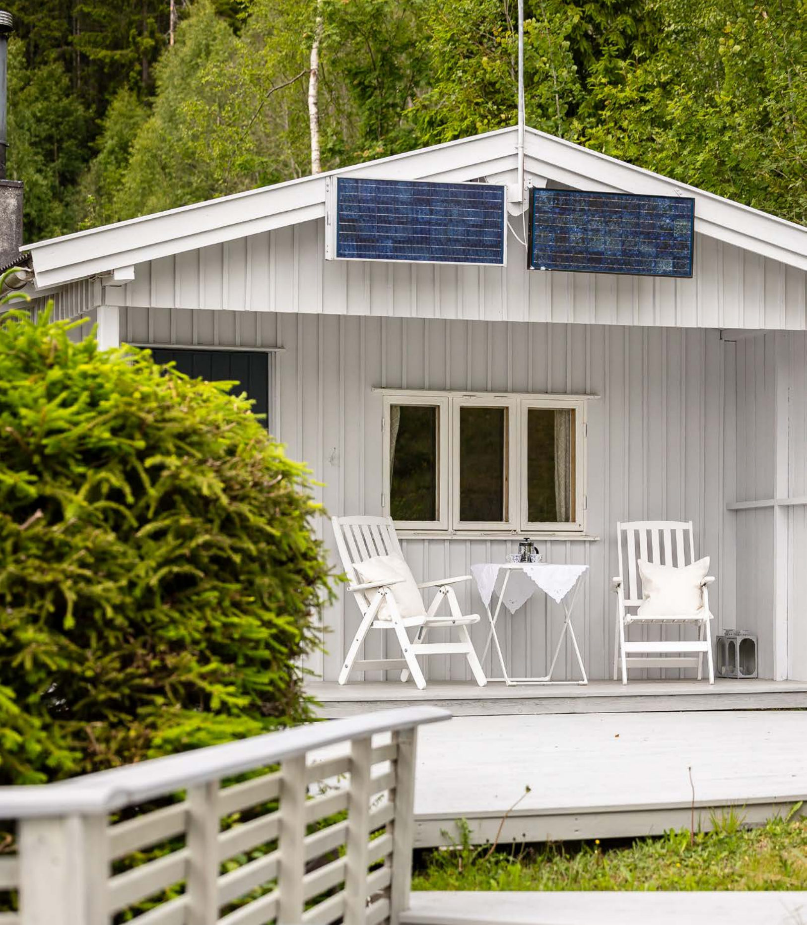
Hytta ble oppført ca. 1972 og har enkel standard uten innlagt strøm, vann eller avløp. Solcellepanel er montert, men regulatoren er defekt.
