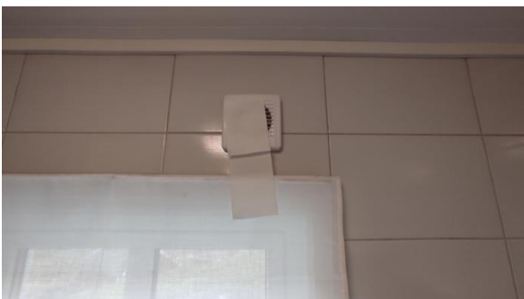
Funksjonstest av avtrekk.
