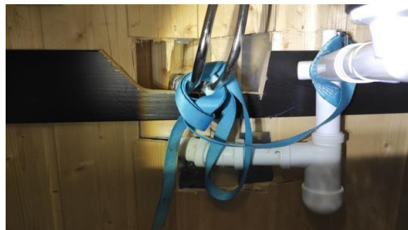
Utette gjennomføringer i innredningen.
