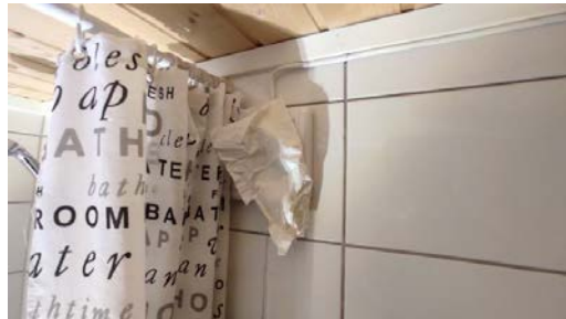
Funksjonstest av avtrekk.
