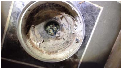
Ingen synlig membran.
