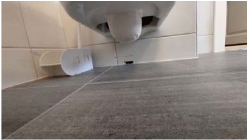
Drensåpning fra innebygd siserne.
