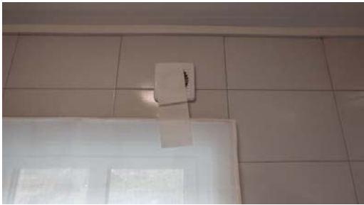
Funksjonstest av avtrekk.
