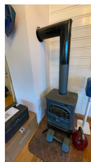
Avstand fra røykrør mot brennbart materiale er 27 cm. Skal være minimum 30 cm.
