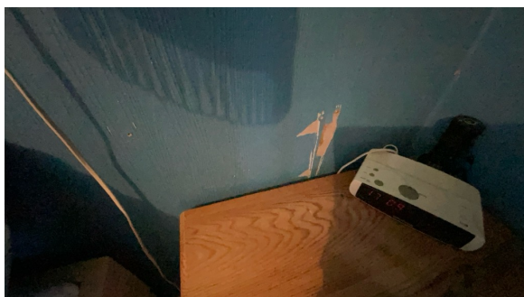
Skade på tapet inne på soverom i 1. etasje
