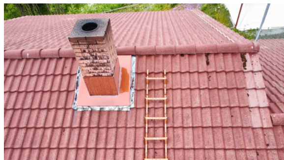
Pipe har sokkelbeslag, mangler toppbeslag og hatt
