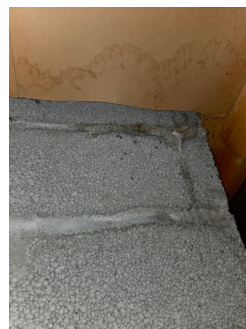
Eldre fuktmerker på undertak ved pipe
