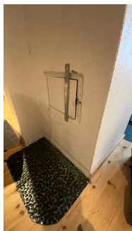
Sikring av sotluke, anbefaler å utbedre lås
