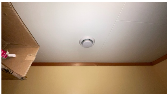
Avtreksventil i himling
