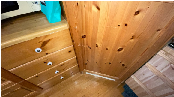
Slitasje på dørfronter ved vaskekum og noe slitasje på øvrige fronter
