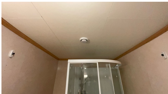
Avtreksventil i himling
