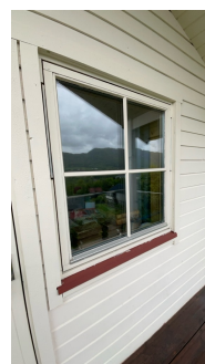
Vindu på soverom virker ikke låsemekanisme
