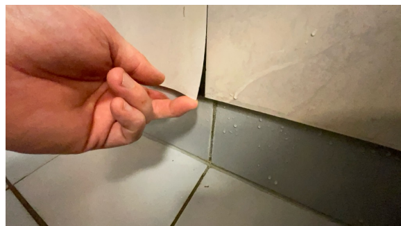
Skade på nedre del av veggplate bak badekar
