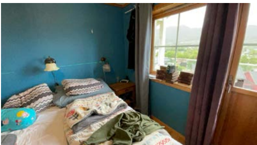
1. etasje. Plassering av laser ved kontroll av soverom. Det er målt 12 mm høydeforskjell gjennom rommet. TG 1
