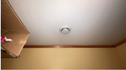
Avtreksventil i himling
