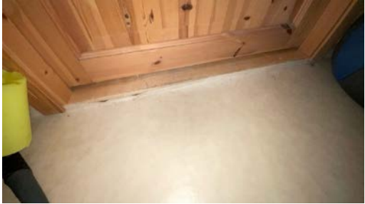
Tilluftsspalte under dør
