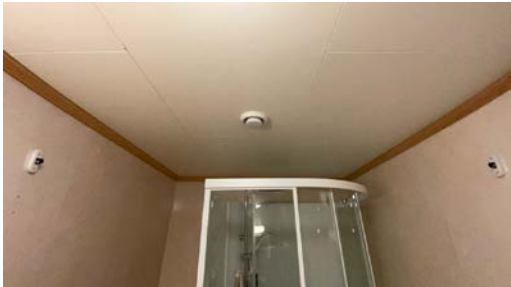
Avtrekksventil i himling
