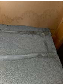
Eldre fuktmerker på undertak ved pipe
