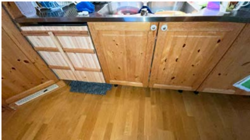
Dørfront på oppvaskmaskin er ikke original. Plassbygd av eier.
