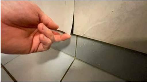
Skade på nedre del av veggplate bak badekar
