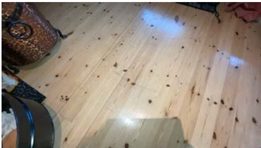
Litt slitasje på furugulv i kjeller
