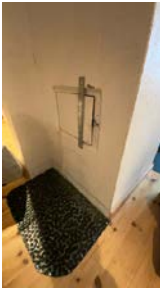
Sikring av sotluke, anbefaler å utbedre lås
