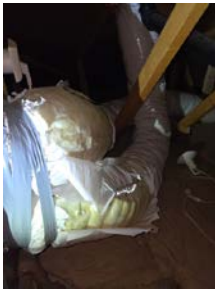
Ventilasjons slanger har plast utvendig oppe på kryploft, plast er sprukket opp og forvitret.
