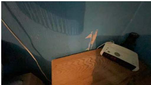
Skade på tapet inne på soverom i 1. etasje
