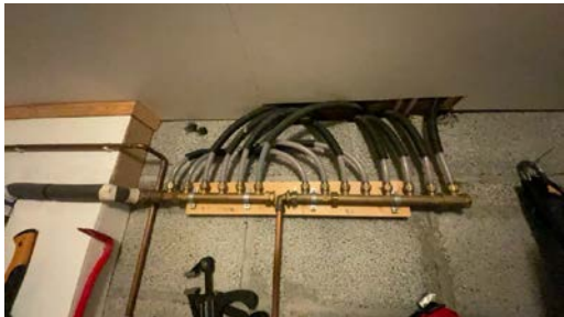
Fordelerkolber plassert åpent på vegg
