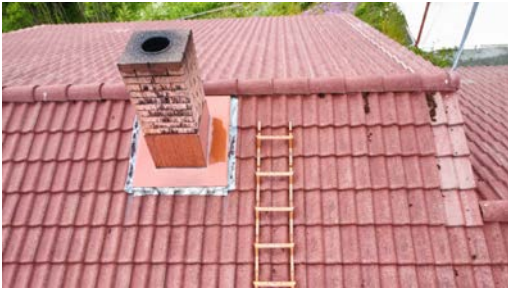
Pipe har sokkelbeslag, mangler toppbeslag og hatt
