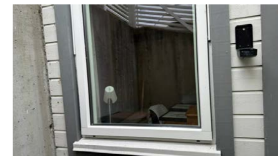
Bilde viser aluminiumsbeslått vindu med god tilstand.
