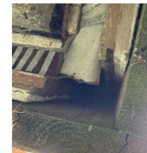
Bilde viser mangelfull tetting med musebånd på hushjørne.
