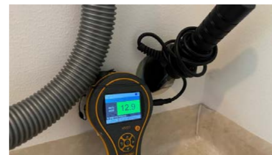
Bilde viser fuktmåling i vegg mot terreng.
