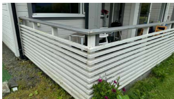
Bilde viser rekkverk og håndlist med behov for overflatebehandling.
