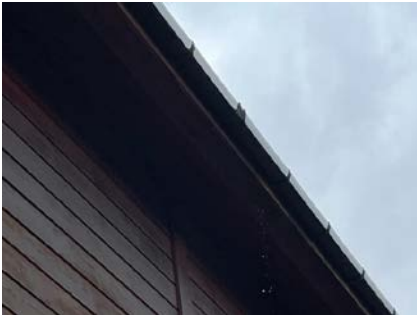
Synlige lekkasjer i takrenner.
