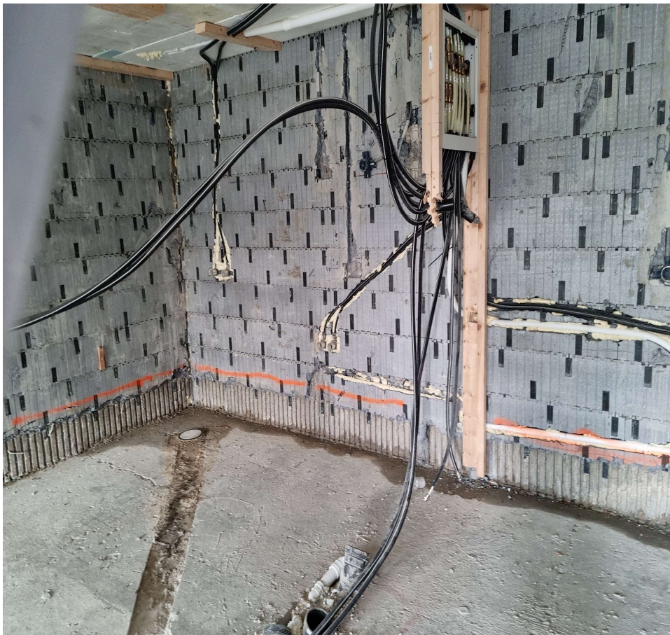
Innv. fukt fra bakvegg
