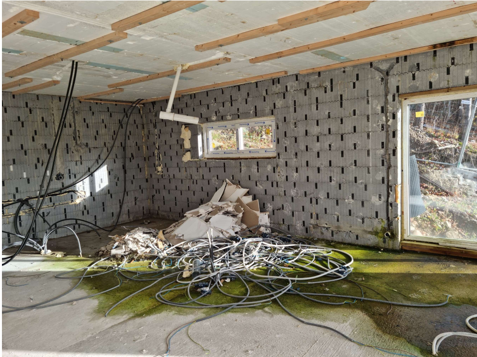
Innvendig fukt med mosegroing i begge boliger
