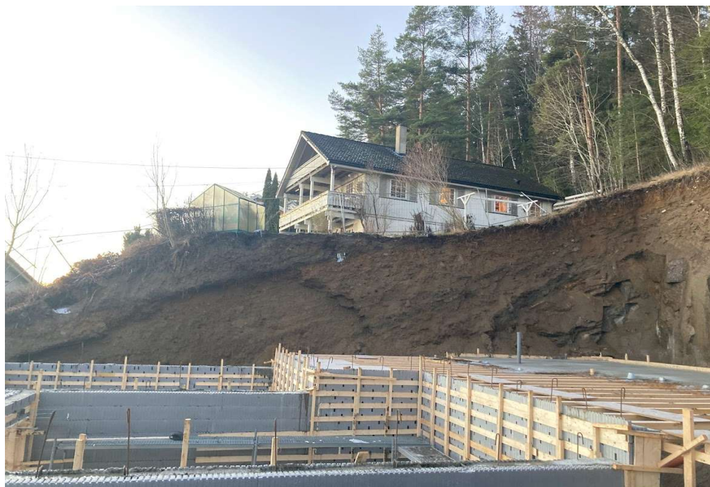
Høy usikret skråning mot Vest
