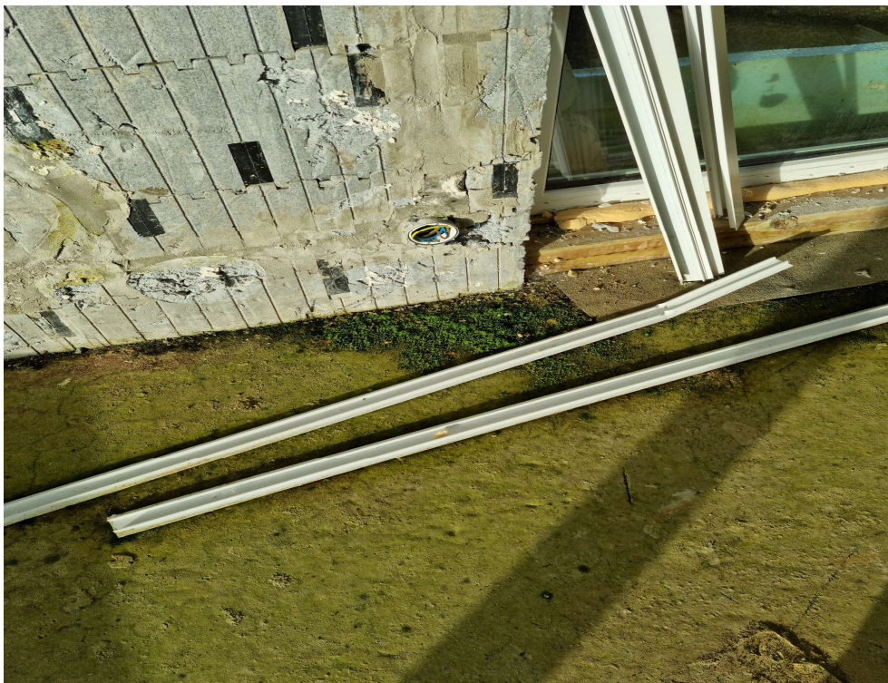
Innvendig fukt med mosegroing i begge boliger
