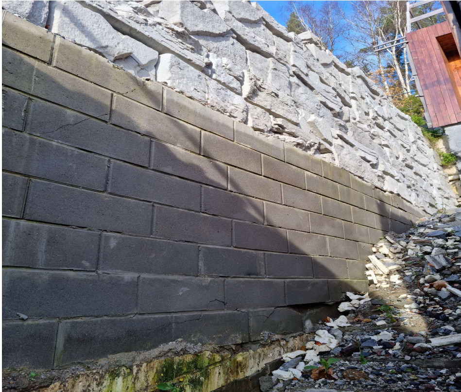
Sprekk i mur av betongblokk under
