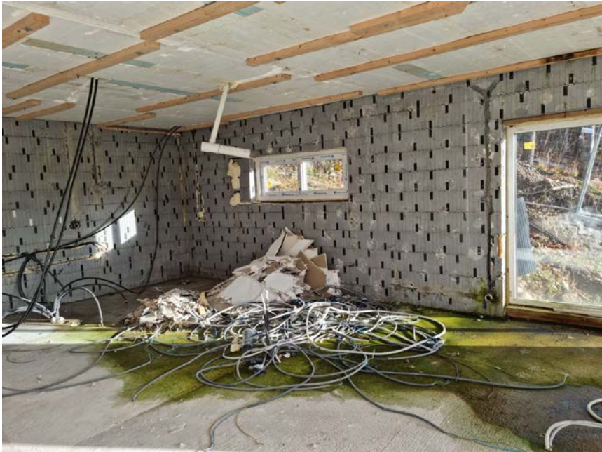
Innvendig fukt med mosegroing i begge boliger
