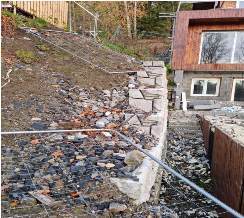
Støttemur mot vest - Ny stablesteinsmur som buler ut
