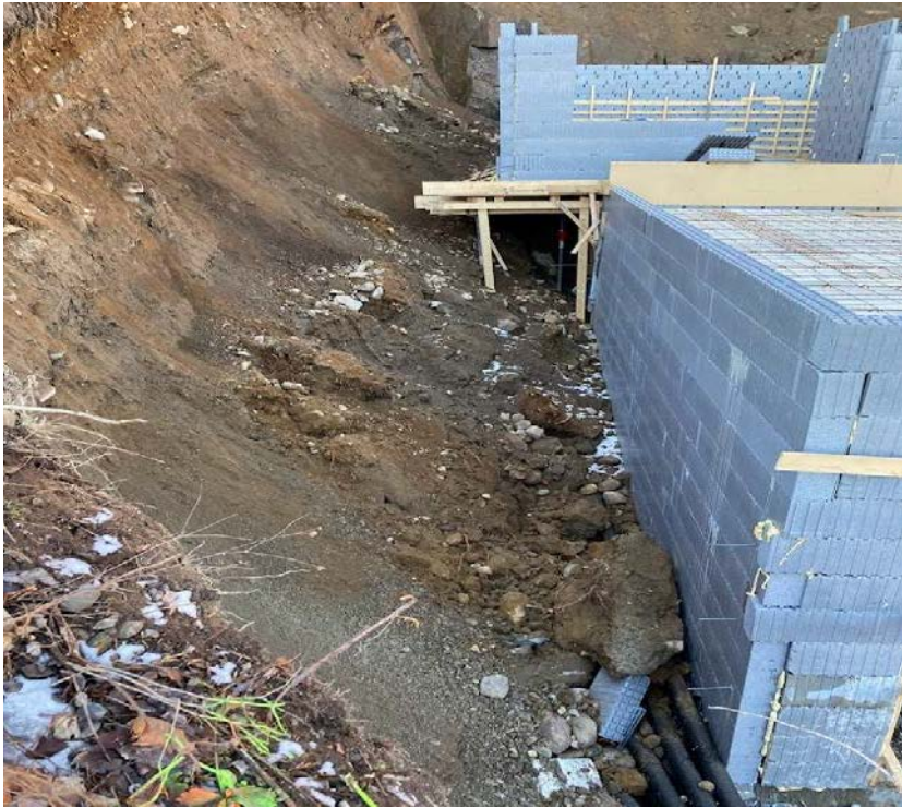
Nedrate masser fra skråning mot Vest- mot drensledning uten grunnmursplast og membran
