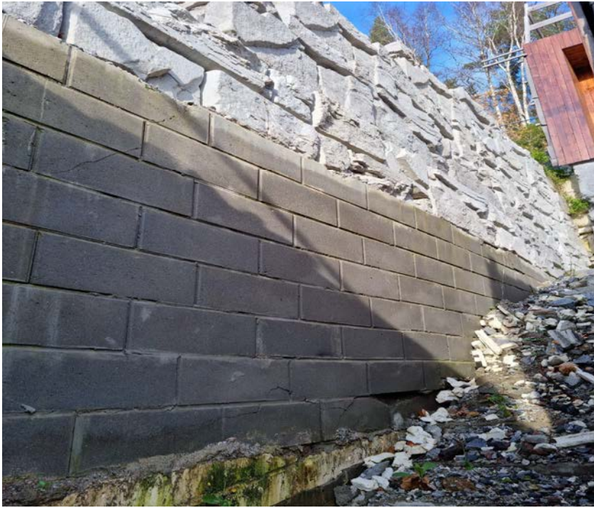
Sprekk i mur av betongblokk under
