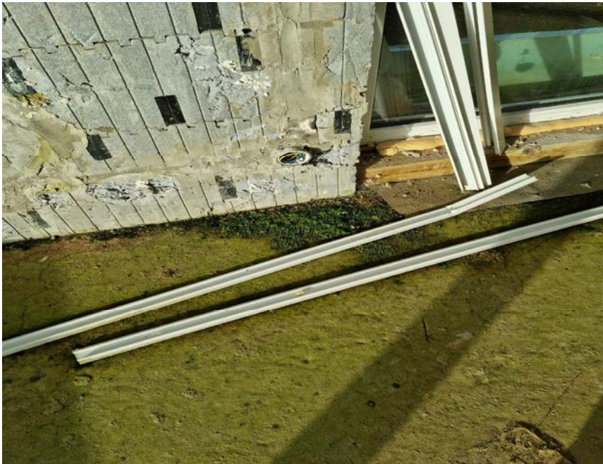
Innvendig fukt med mosegroing i begge boliger
