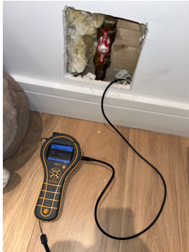
Fuktmåling i tilstøtende vegg mot våtsonen.
