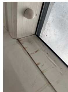
Skade vindu innglasset balkong
