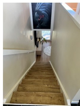
Trapp mangler håndløper på vegg.
