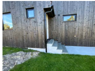
Nedløpet er ikke ledet bort fra bygget.
